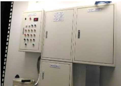
機房連動測試
